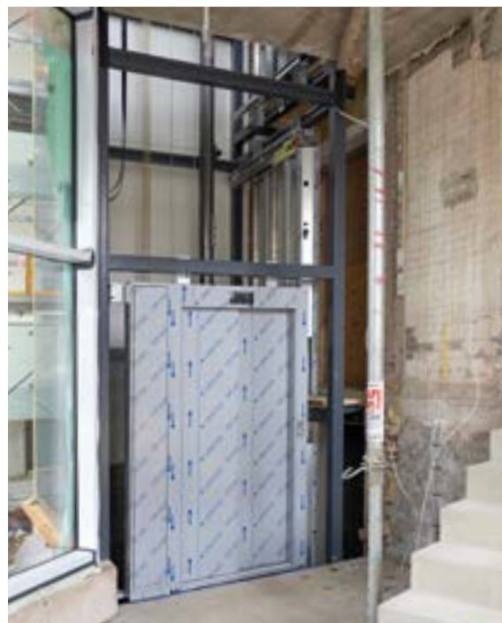
Der Fahrstuhl am Haus Letzter Heller 32 befindet sich im Eingangsbereich, fährt bis in den Keller und ging im Frühjahr 2021 in Betrieb.
