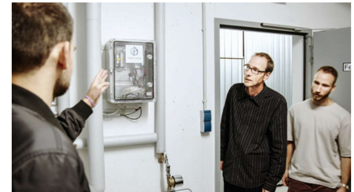
Schnittstelle von Green Fusion im Heizungskeller
